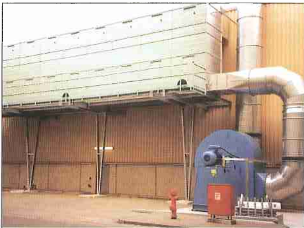
Reihenfilteranlage mit integriertem Kettenförderer
