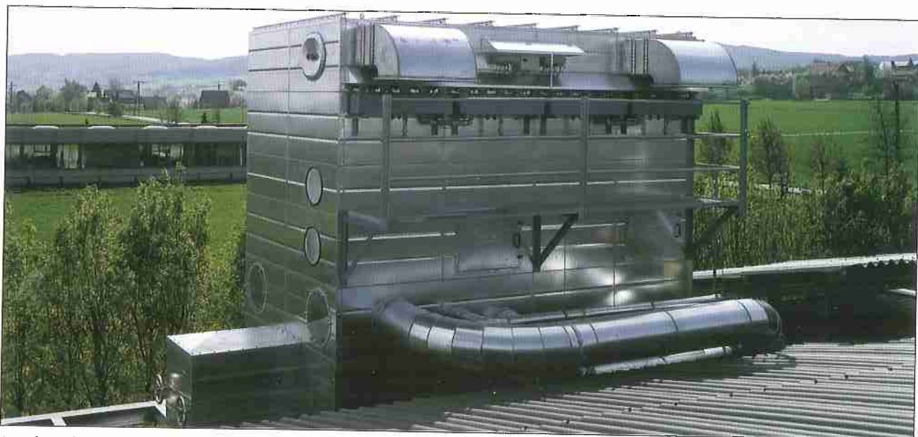
Jet-Filteranlage PVJL mit 230 m 2 Filterfläche; Abluftbetrieb
