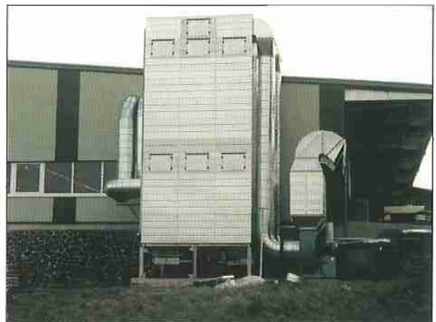
Unterdruck-Filterhaus mit Zwischenpuffer und Rührwerksaustragung
