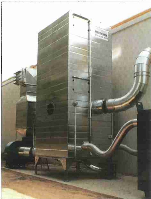
Unterdruck-Zwischensilo-Filter mit Hochleistungsventilator und Containerbeschickung
