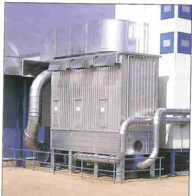
Dezentrale Aufstellung auf einem Betonfundament, PGSQ mit drei Elementen
