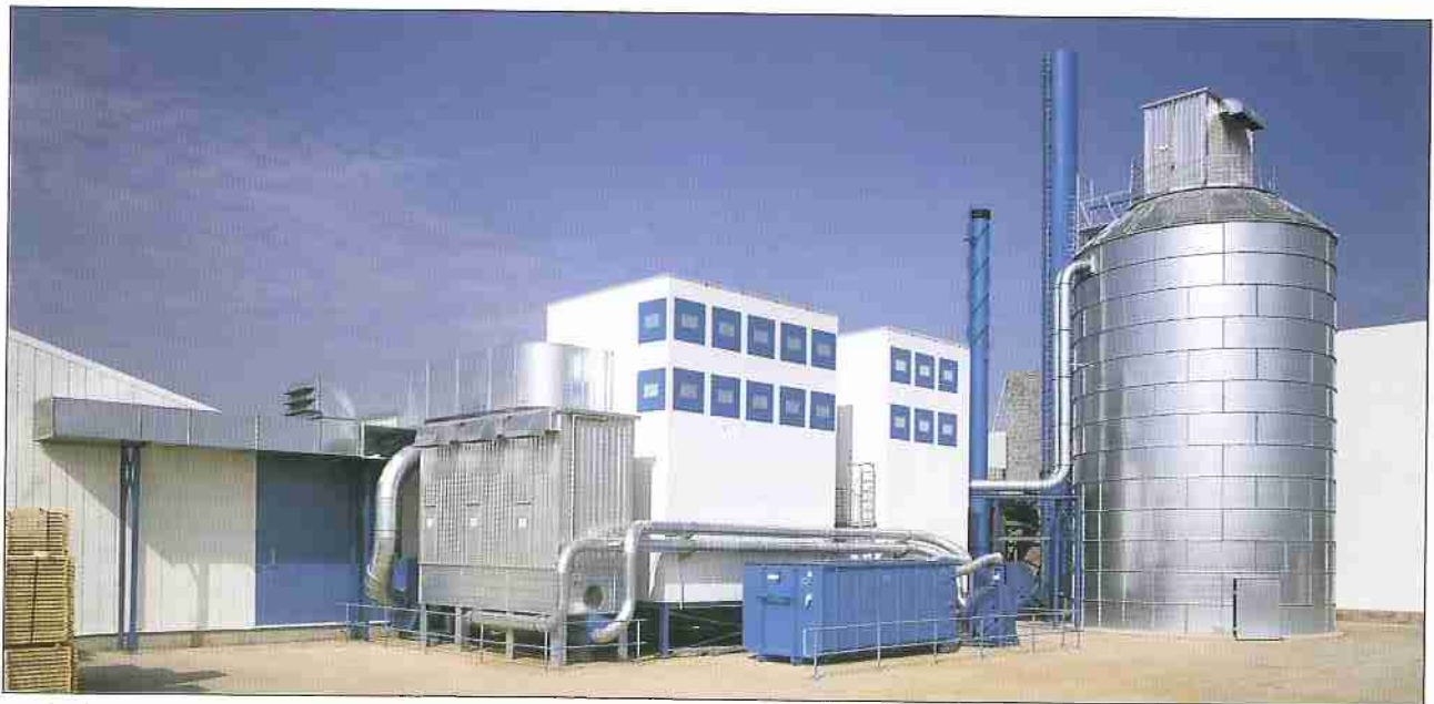
Großanlage: Zwei Filterhäuser PFHA mit Rückluftkanal, Transportanlage zum Silo bzw. Deckenfilter sowie separate Filteranlage PGSQ mit Containerbeschickung für Lackschliff
