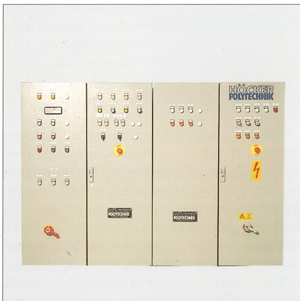
Anlagensteuerung durch übersichtliche, zentral angeordnete Schaltschränke
