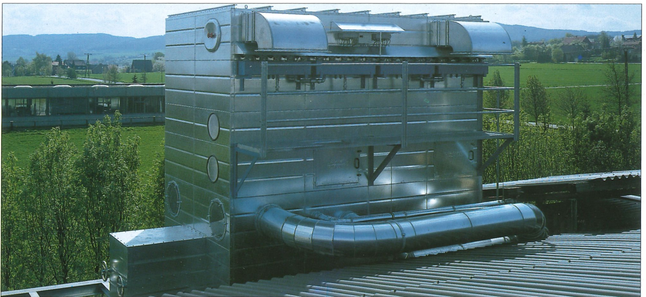
Jet-Filteranlage PVJL mit 230 m 2 Filterfläche; Abluftbetrieb
