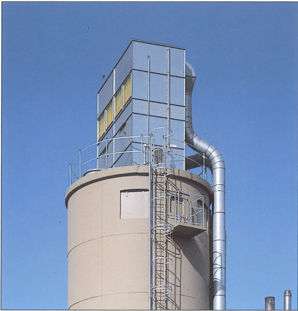
Zentral auf einem Silodach montierter Kompaktfilter
