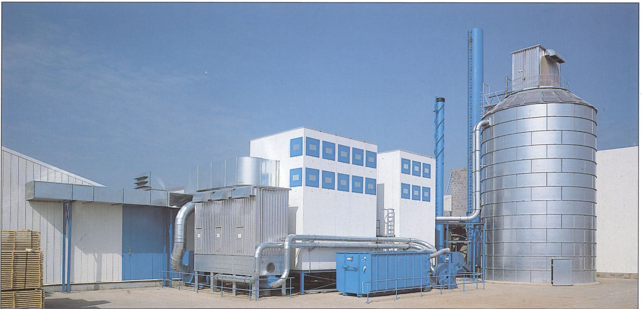
Großanlage: Zwei Filterhäuser PFHA mit Rückluftkanal, Transportanlage zum Silo bzw. Deckenfilter sowie separate Filteranlage PGSQ mit Containerbeschickung für Lackschliff
