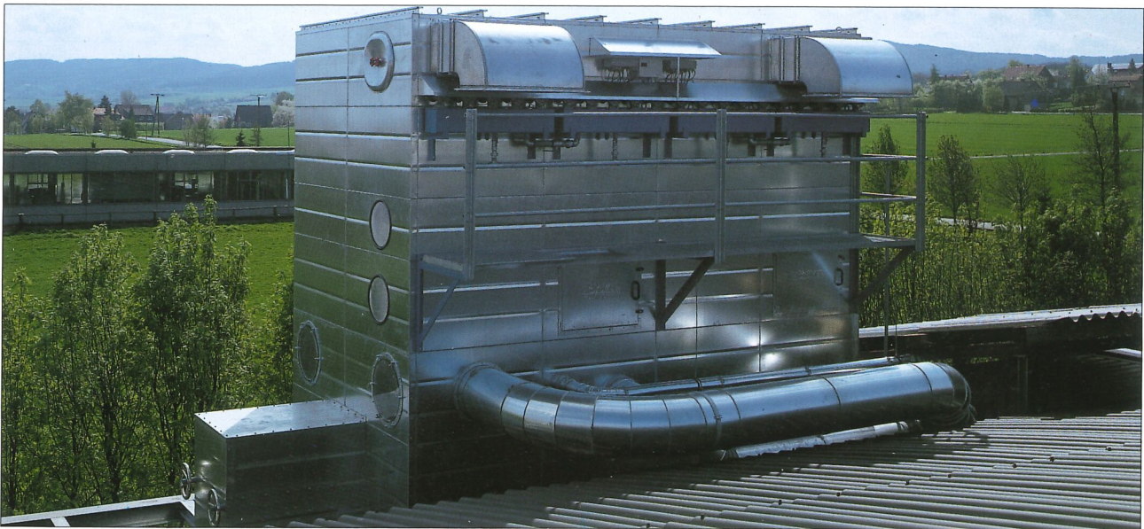
Jet-Filteranlage PVJL mit 230 m 2 Filterfläche; Abluftbetrieb
