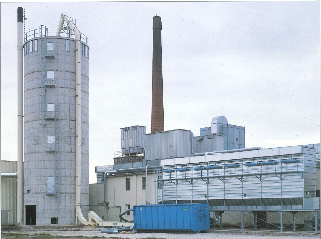
Industriefilter VacuJet, Typ PVJL 2000 mit Trogkettenförderer zur Silobeschickung, 850 m 2 Filterfläche
