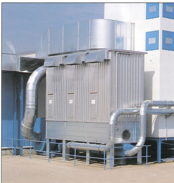
Dezentrale Aufstellung auf einem Betonfundament, PGSQ mit drei Elementen
