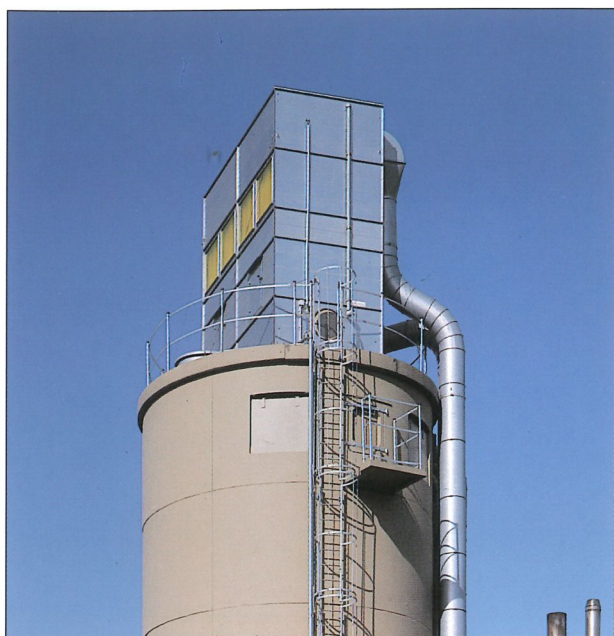
Zentral auf einem Silodach montierter Kompaktfilter
