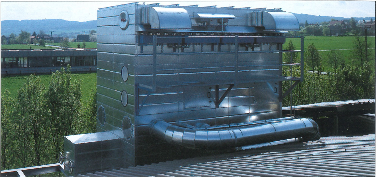
Jet-Filteranlage PVJL mit 230 m 2 Filterfläche. Abluftbetrieb.
