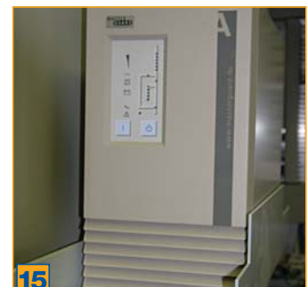
15 Sistema de alimentación ininterrumpida (SAI), para prevenir averías causadas por fluctuaciones en la tensión de red y pérdidas de datos por cortes del fluido eléctrico
