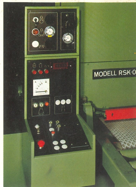
Bild 2: Zentralsteuerpult mit Notschaltleiste
