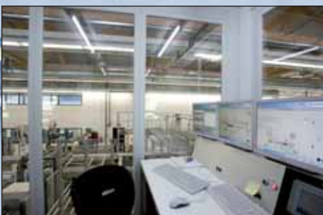
Kontroll- und Anlagenleitstelle
