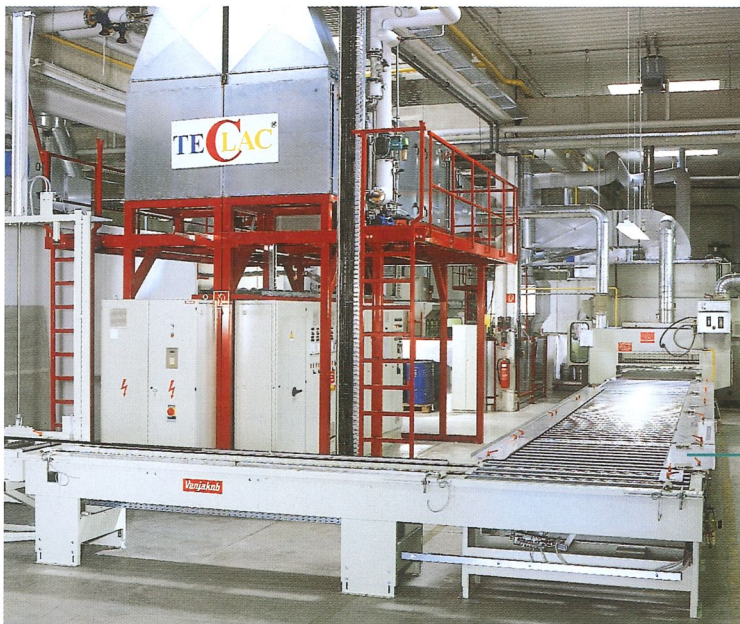
Oberflächenanlage zur Beschichtung von PKW-Kunststoffteilen
