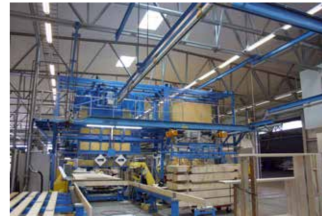
Blick über die Riegelwerkstation FM3000, ausgestattet mit dem weltweit modernsten System für die Handhabung von Isoliermaterial.
