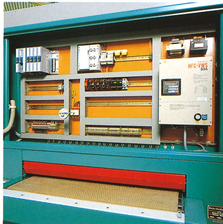
Schaltschrank mit der Elektronik-Steuerung
