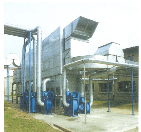
Gegendruckfilteranlage im Überdruck mit Spänetransport-ventilatoren.
