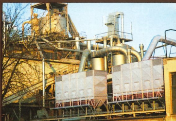
Großstauber für kontinuierlichen Betrieb in einem Spanplattenwerk
