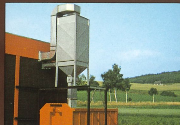
Filteranlagen zur Containerbeschickung mit Lufrückführung
