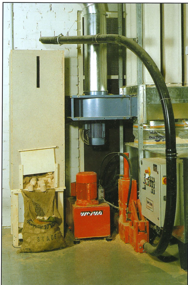
Montage a posteriori sous une installation de filtres à sac
