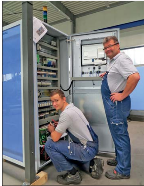
Mechatronikerlehrling Domenic Karsties (links) und Instandhaltungsmechaniker Henry Berthold an einem Schaltschrank einer CNC-Anlage zur Plattenbearbeitung.
