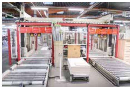
IMA MEINERT UBS4D/ST1, Baujahr 1999 Beschick- und Abstapelanlage
