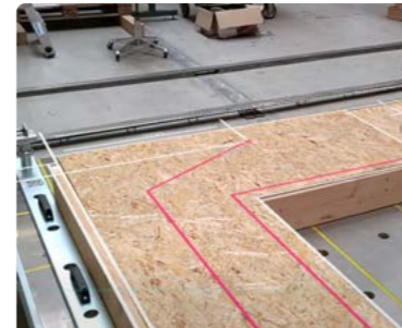
Augmented Reality Detaillierte Baupläne in Echtgrösse projizieren. Da- ten für jeden Arbeitsschritt immer im Blickfeld, ganz ohne Papier!
